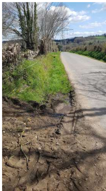
Fossé permettant l'écoulement de la parcelle jusqu'à la buse, puis jusqu'au cours d'eau
