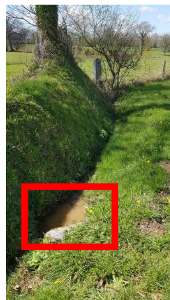
Prélèvement C3P2 : accumulation à la sortie de la buse
