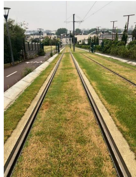
Figure 6 : Gazon de la ligne A du tramway d'Angers jauni à cause d'un manque d'eau, descente du CHU (Orand, 2021)
