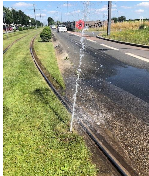
Figure 22 : Fuite sur le tramway d'Angers à la suite d'un arroseur cassé, Avenue Mendès France (Orand, 2021)
