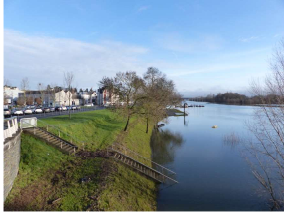
Figure 22 : Forts talus le long des berges (Source : D'ici Là, 2021)
