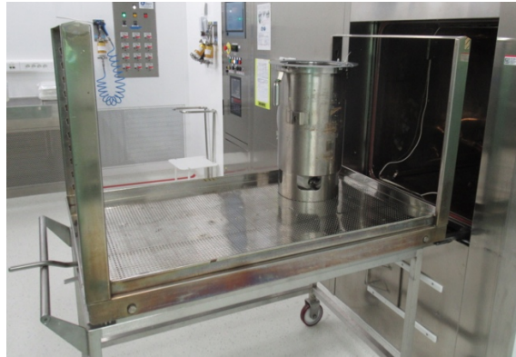
Figure 64 : Configuration d'une charge minimale : un seul canister dans l'autoclave sur site
