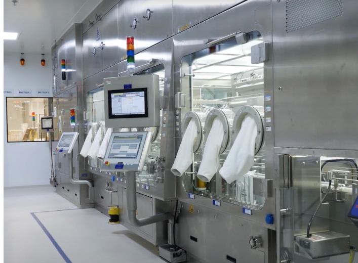
Figure 12 : Equipements assemblés de la ligne de remplissage (photographie prise sur site)
