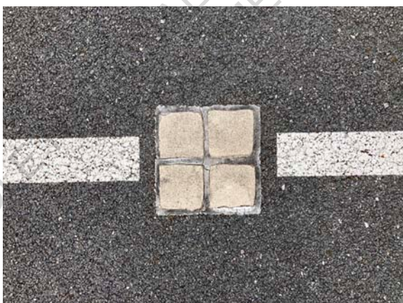
Figure 260 : Trace de poteau en fonte sur le parking de l'école HEI
