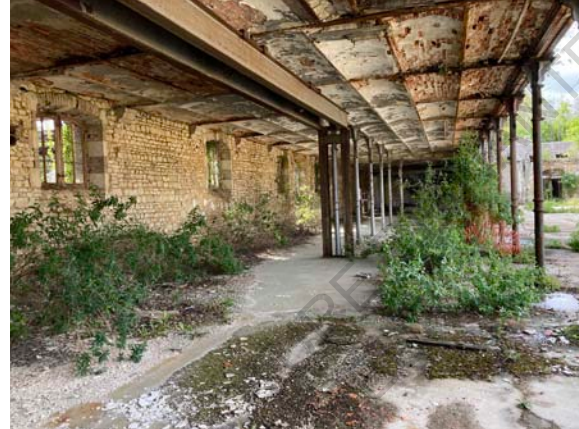
Figure 315 : Vue intérieure du bâtiment intermédiaire de l'usine Balsan, se développant dans la longueur
