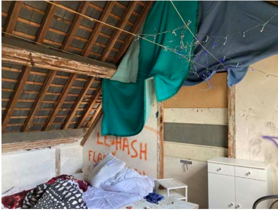
Figure 338 : Vue du squat organisé au niveau des combles de la Manufacture Royale de Draps
