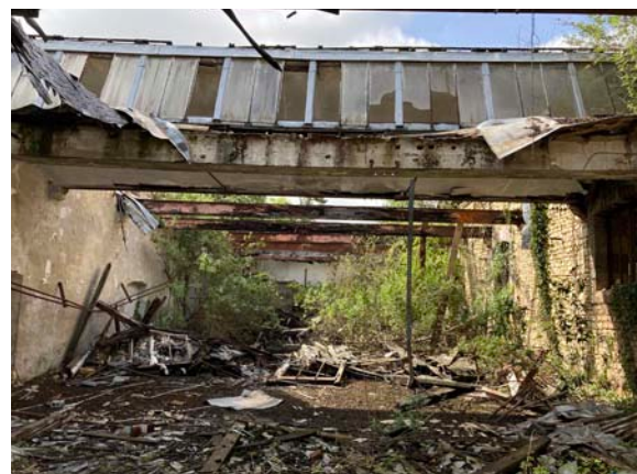
Figure 317 : Vue Sud des sheds, l'espace étant envahi par la végétation et donc le plus dégradé
