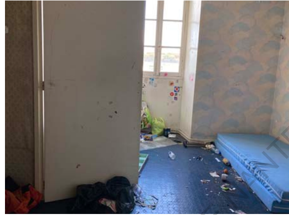
Figure 339 : Vue du squat organisé au sein des anciens logements dans la Manufacture Royale de Draps
