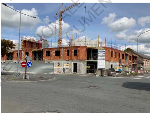
Figure 53 : Vue du chantier de construction de la résidence du Boulevard de la Valla
