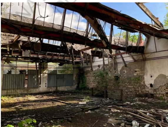
Figure 316 : Vue Nord des sheds, l'espace étant le moins dégradé du bâtiment
