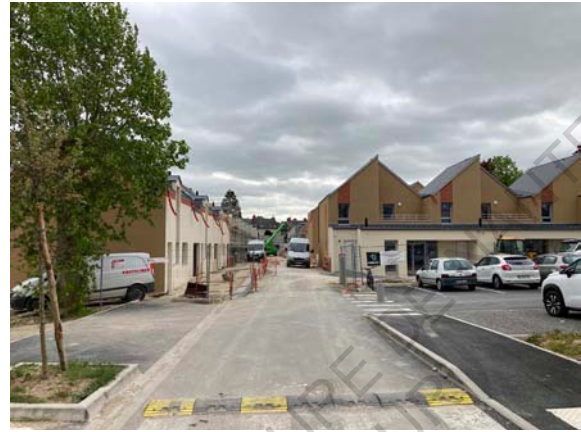
Figure 56 : Vue du chantier de construction des maisons sur le site des 100 000 Chemises
