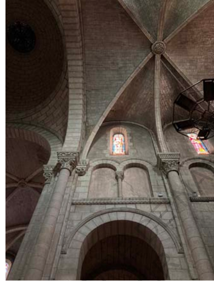
Figure 16 : Vue intérieure de l'église Notre Dame et de ses fissures
