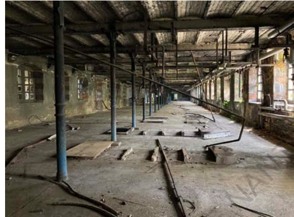
Figure 295 : Vue intérieure du RDC du Flockage dans une partie plus dégradée
