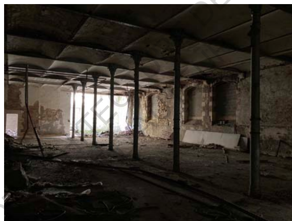
Figure 319 : Vue du niveau inférieur du bâtiment, dont les hangars au Nord sont en partie effondrés
