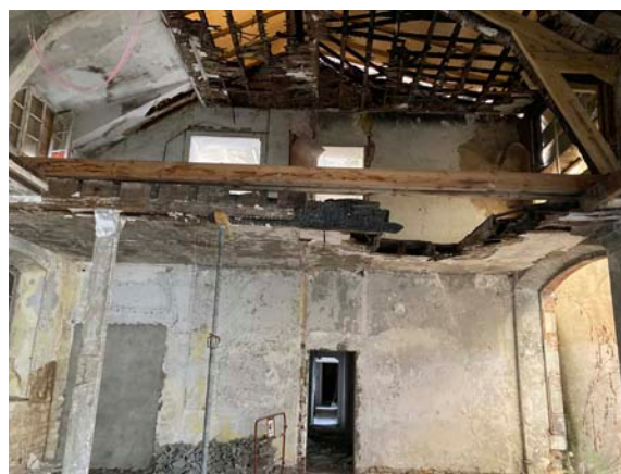
Figure 313 : Vue intérieure de la partie incendiée des bâtiments d'expédition de l'usine Balsan
