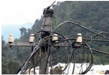
Branchements sauvages à Cayenne, source : Guyane 1 ère
