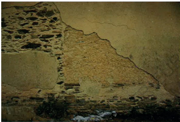
Fig.133 - Juxtaposition de deux types de murs : à droite, un mur de terre sur soubassement schiste, et à gauche, un mur de moellons de schistes tout venant. Sur l'ensemble un enduit de mortier de chaux naturelle et sablé local - Simplé (53).
