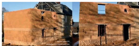
Fig.182 - Reconstruction du murs en bauge (50), réalisation «Les Frères Bon», photographies François Streiff.
