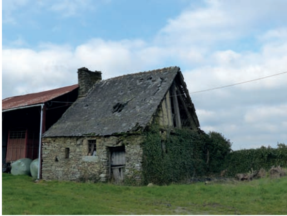
Fig.143 - Petite remise avec une partie du pignon en pan de bois avec remplissage en terre crue au lieu-dit Le Bourgueray, à Thubœuf (53).
