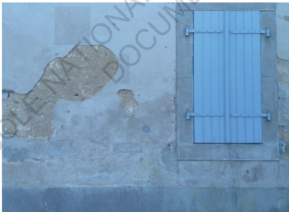
Fig.142 - Petite maison enduite dans le quartier Avesnière laissant apparaître le mur en terre sur soubassement à Laval (53).
