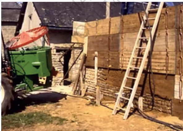
Fig.173 - Chantier de reconstruction d'un mur effondré en pisé, photographie de François Streiff.
