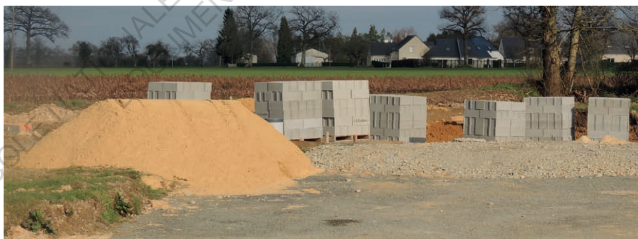
Fig.87 - Palettes de parpaing, dans le lotissement du «Clos de la Brosse» à Aron.
