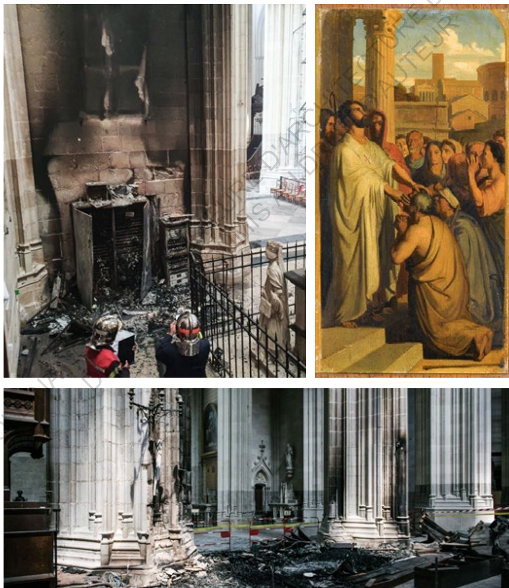
Fig. 44 : Photographies des dommages à l'intérieur de la cathédrale et du tableau disparu de la cathédrale, d'Hippolyte Flandrin, Saint-Clair rendant la vue à un aveugle.
