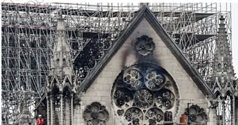
Fig. 36 : Photographie des dégâts sur les rosaces de la façade Sud
