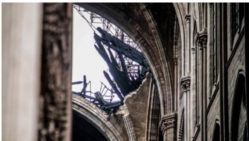
Fig. 34 : Photographie des décombres de Notre-Dame, vue du trou dans la toiture et les voûtes, par le portail d'entrée
