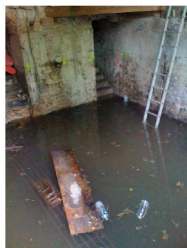
Inondation du sous-sol le 22/07/2013
