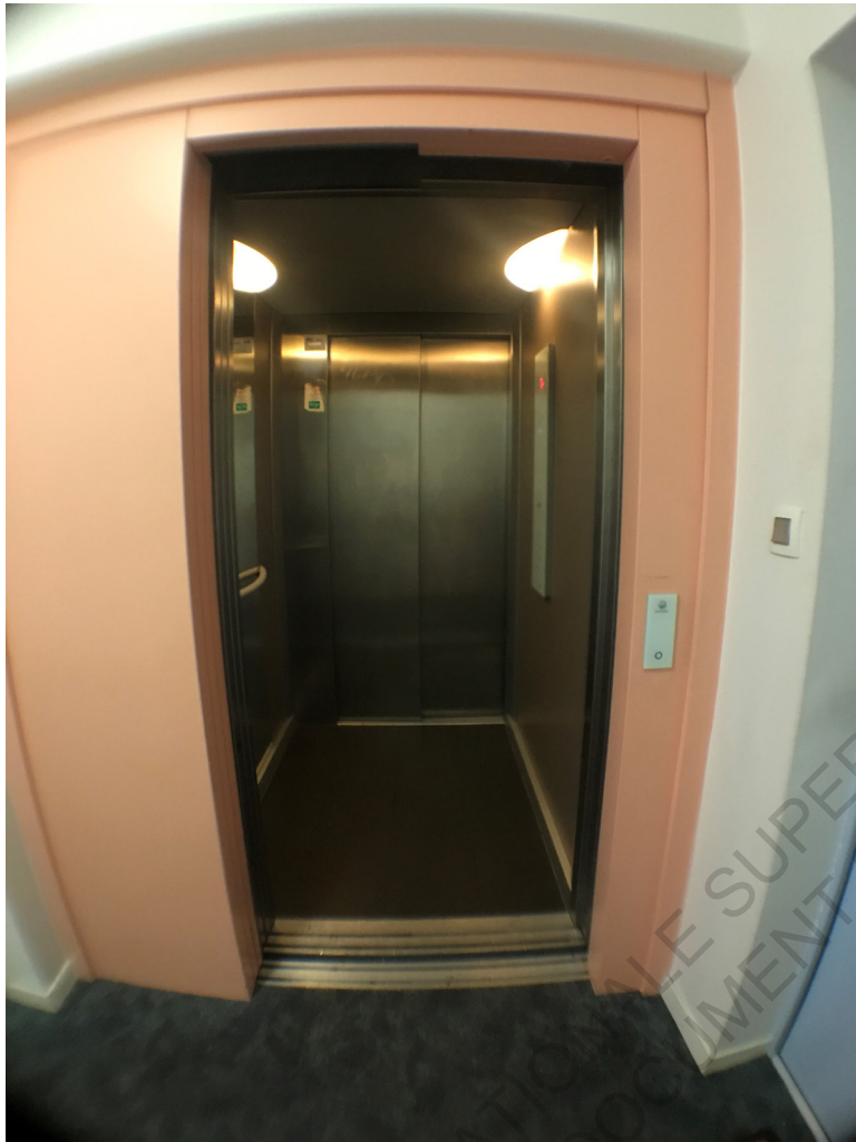
L'ascenseur des immeubles de l'îlot Prairie au Duc. photo personnelle.
