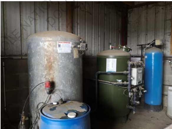
Fig.45 - Installation de traitement de l'eau de la ferme de la Grée - Photo personnelle
