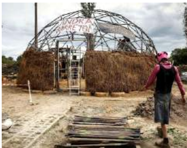
Fig 5 : Un Géodome rempli en terre-paille sur la ZAD de Notre-Dame-des-Landes (photo : Arnaud Dumontier) (Méréo, 2020)
