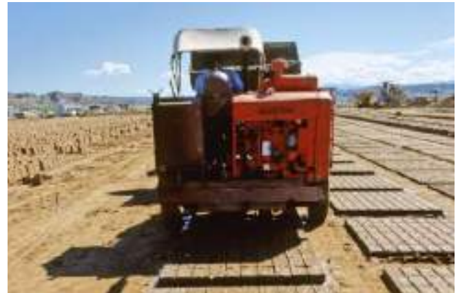
Fig. 3 : Aux États-Unis, une pondeuse à adobes produit plusieurs milliers de briques par jour (Anger, Fontaine, 2009, p.44)
