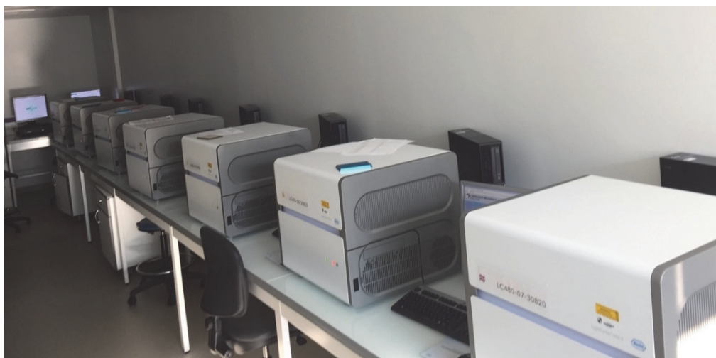
Figure 12 : La pièce des PCR et RT-PCR du plateau technique de Biologie Moléculaire de l'IHU Méditerranée Infection, Marseille.
