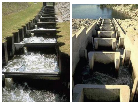
Passes à fentes verticales Méricourt (78) –rivière Seine et passes à fentes verticales Bonicoll-rivière Gardon (GHAAPPE, 2006)
