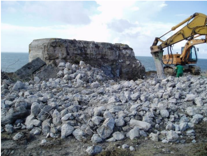
Figure 6 : La démolition d'un bunker à cause de son mauvais état à Pornic (Phytolab, 2003)
