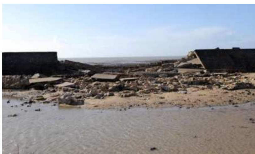
Figure 16 : Rupture de la digue de Quiberville-sur-Mer (Source : CD76, 1978)
