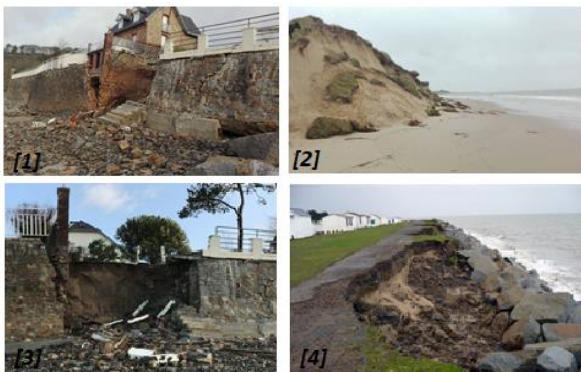
Figure 1 : Dégâts à Saint-Jean-le-Thomas suite à la tempête Eleanor 03/01/2018 (source: Hydratec) [1][3] Effondrement des murs de soutènements de la Villa des Dunes ; [2] Recul de la dune ; [4] Destruction de l'énrochement de la plage Saint-Michel.
