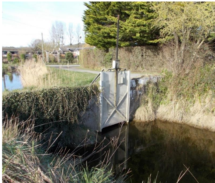
Figure 16 : Porte à flot en aval du Pont Neuf (Source: visite terrain 09/02/2018)
