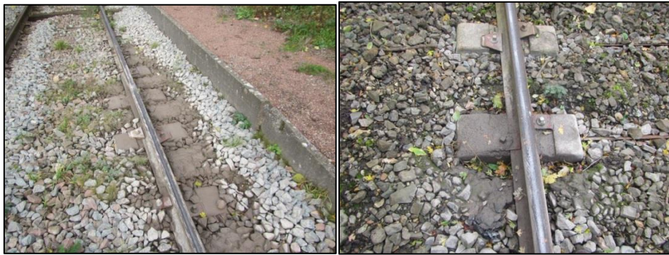
Figure 6. Photographies de remontées boueuses sur le projet Saint Pol – Source interne
