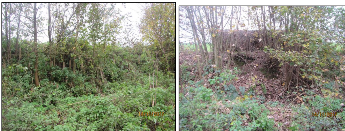
Figure 15. Coulées de boues et anciens travaux de maintien de l'OTS en déblai entre les Pk 126+586 – Pk 127+050 (photo prise depuis la voie) – Source interne
