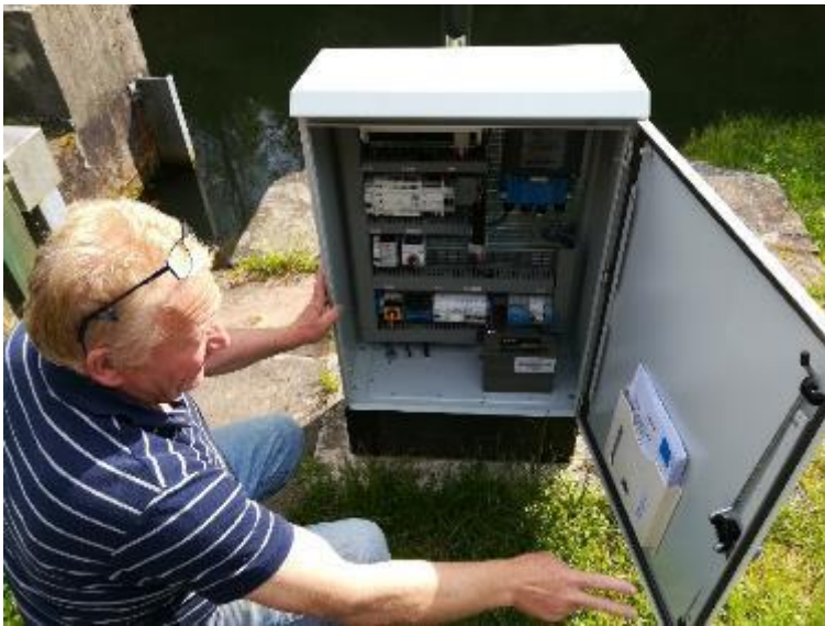
Figure 19 Agent Raymond Schneider qui intervient sur l'automate d'un barrage à clapets
