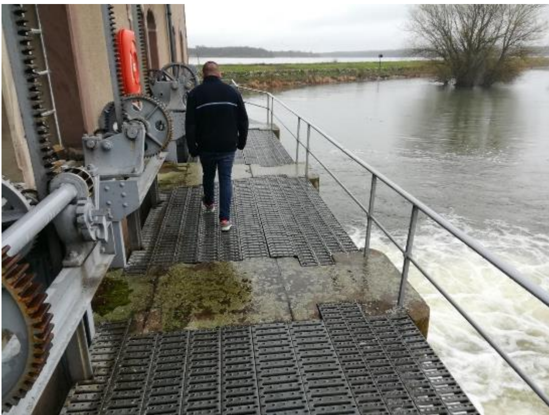
annexe 13 refoulement de l'usine élévatrice de Gondrexange et en arrière-plan la cornée du Gros Étang
