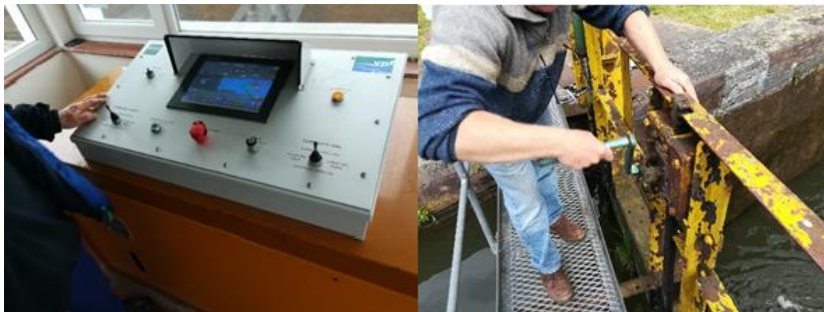
Figure 28 A gauche, un IHM présent dans chaque écluse (l'automate est derrière) et à droite un agent travaille sur la vantelle de l'écluse 18
