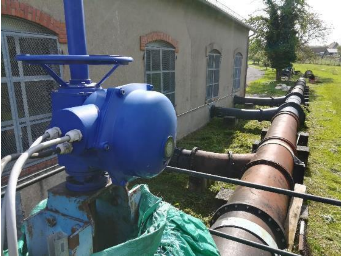
annexe 14 Vanne "pourcent" au premier plan et station de pompage à gauche
