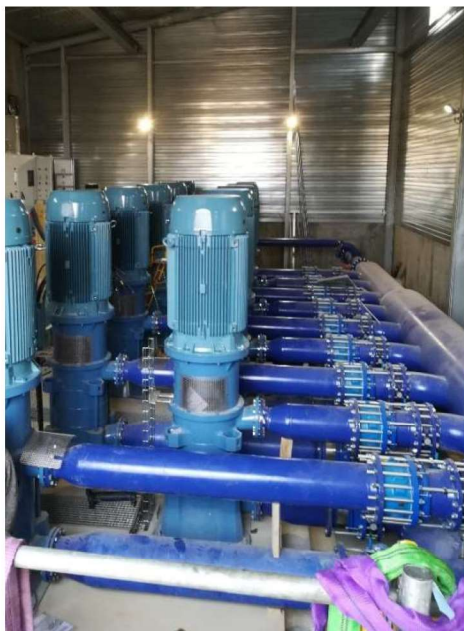
Figure 8: Photographie des groupes électropompes et des équipements hydrauliques qui composent la station de l'ASIA
