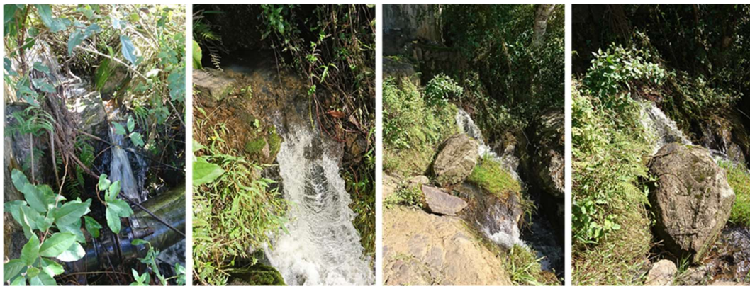
Figure 18: Fuites du barrage 6 (aval du barrage)
