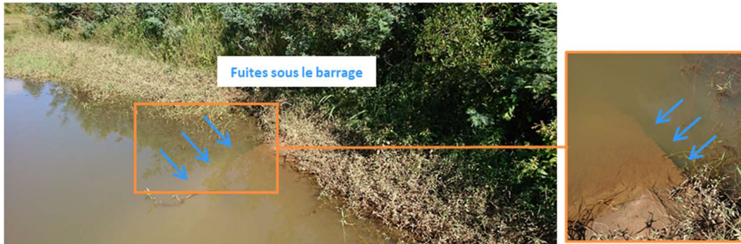
Figure 17: Fuites du barrage 6
