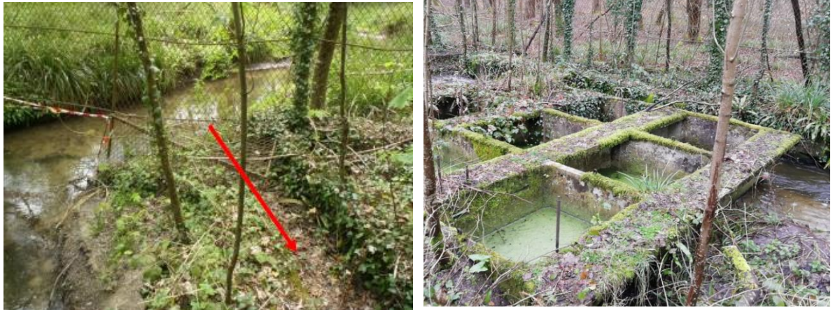
Figure 30: Photographie de l'ouvrage R7. Gauche : amont de la pêcherie, la flèche rouge indique l'entrée d'un canal de décharge maçonné, longeant l'ouvrage. Droite : Bassins en béton (source : ONF et CARICAIE)
