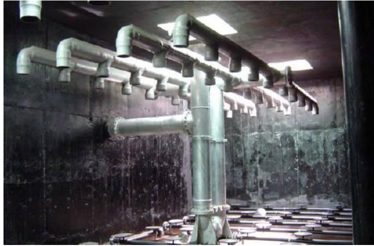
Figure 55 - Siphon de reprise de l'eau traitée
