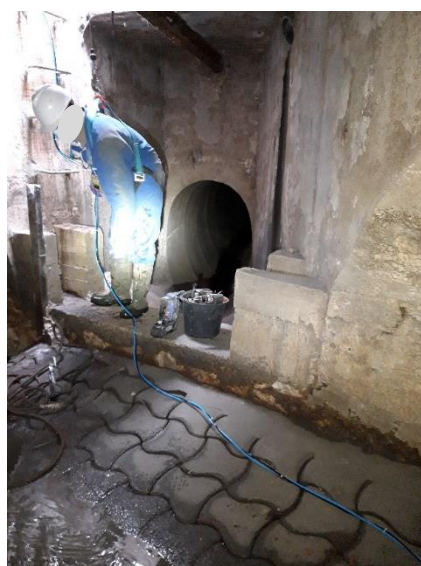
Figure 16 Vue de la surverse en aval du point de mesure (PT3) source Chartres métropole
