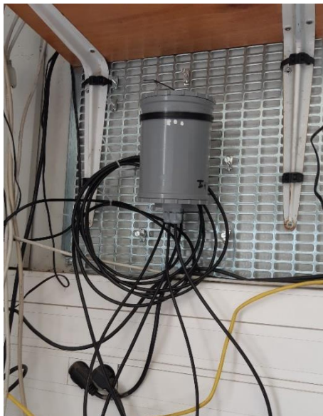
Figure 33 : Boîtier d'enregistrement installé dans le bungalow (1er juillet 2021)
