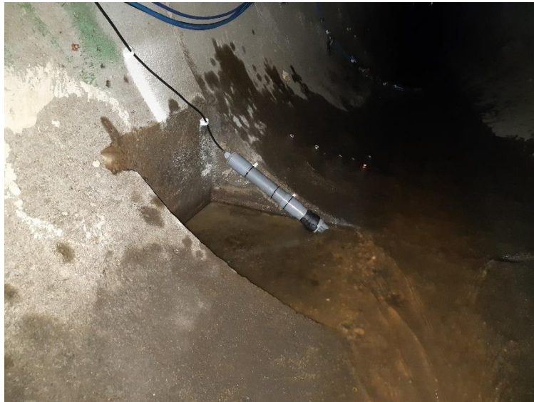
Figure 36 : Installation de la sonde de turbidité dans un renforcement de la canalisation (16 juillet 2021)
