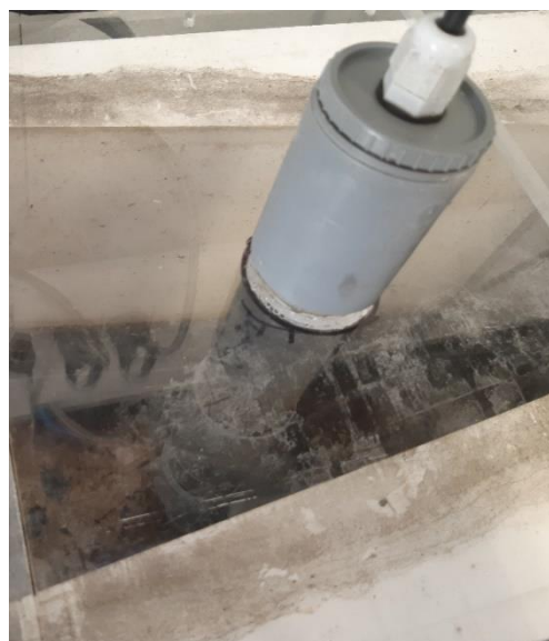
Figure 34 : Sonde de turbidité installée dans le canal (1er juillet 2021)
