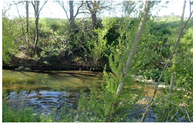
Figure 31 : Erosion de 2,5 m en rive concave de l'Arc, secteur des Milles, pk 33
