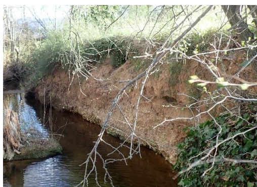
Forte érodabilité des berges, ruisseau de Saint-Pancrace (UF1)
