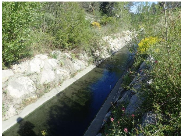
Figure 38 : Amont du Ruisseau de Baume-Baragne à l'aval de la zone industrielle de Plan de Campagne à Cabriès (13)
