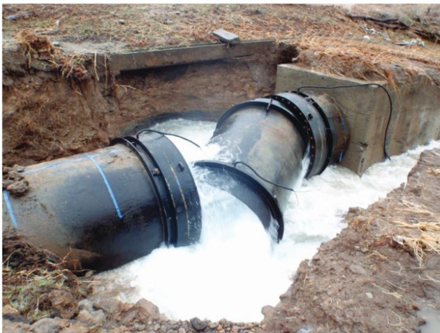
Figure 11: Dommages sur une canalisation de 2400mm causés par le séisme du 11 mars 2011, Source : Préfecture de Miyagi
