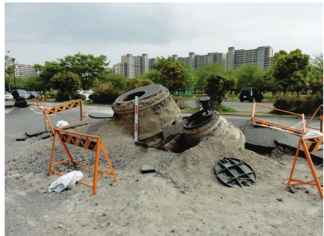
Figure 12: Soulèvement d'un réservoir enterré causé par le séisme du 11 mars 2011, Source : Préfecture de Chiba
