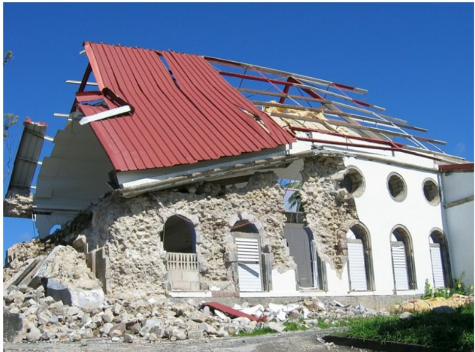
Figure 2: Endommagement de l'église de Terre-de-bas (Saintes, Guadeloupe) suite au séisme du 21 novembre 2004, Source : BRGM/GéoRisque
