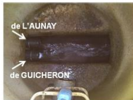
Figure 19 : Ecoulement accompagné au refoulement du PR L'AULNAY à Laval
