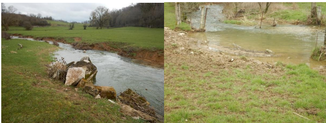
Figure 53 : Berges dépourvues de végétation et piétinement, Les-Hauts-de-Chée_17/03/2021
