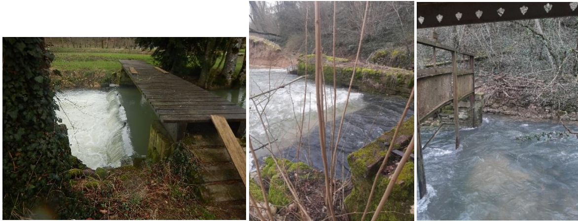
Figure 61 : OU8 à supprimer et Ancien vannage OU9 à aménager, Les-Hauts-de-Chée_17/03/2021 (Source : IRH)
