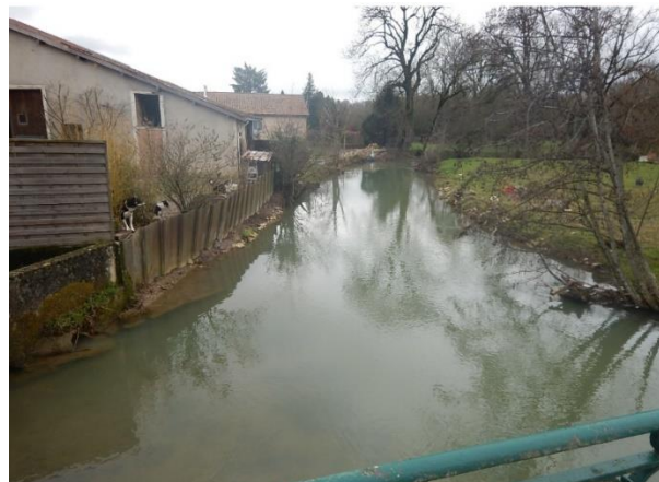
Figure 63 : zone d'érosion de berge, Les-Hauts-de-Chée_17/03/2021 (Source : IRH)
