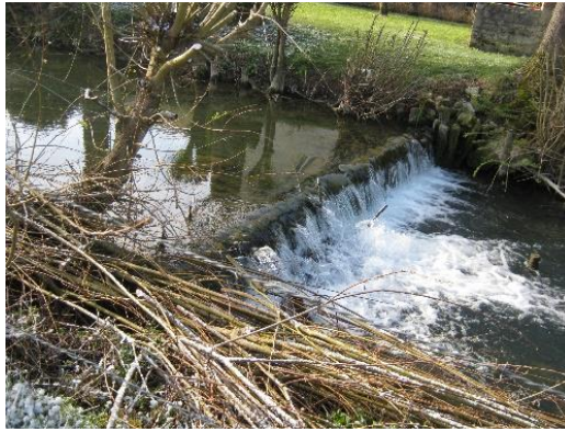
Figure 79 : Seuil OU16 à supprimer, Les-Hauts-de-Chée_07/04/2021 (Source : IRH)
