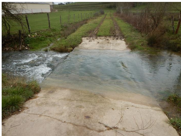
Figure 46 : Passage à gué bétonné impactant OU3, Les-Hauts-de-Chée_17/03/2021
