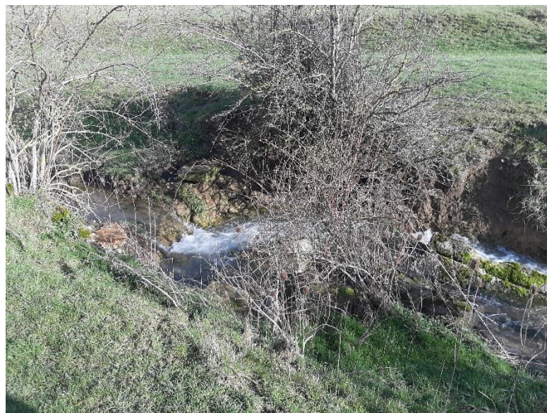
Figure 65 : OU10 à supprimer, Seigneulles_17/03/2021
