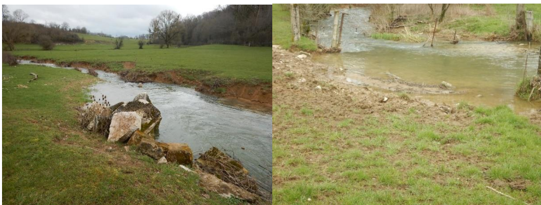
Figure 53 : Berges dépourvues de végétation et piétinement, Les-Hauts-de-Chée_17/03/2021
