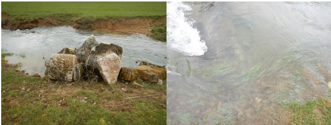
Figure 52 : Seuil OU6 détruit à gauche et canalisation à droite, Les-Hauts-de-Chée_17/03/2021
