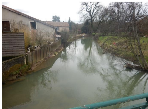
Figure 63 : zone d'érosion de berge, Les-Hauts-de-Chée_17/03/2021 (Source : IRH)
