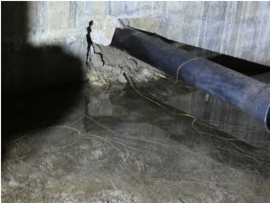
Présence d'eau et de racines (DESint_1 et DESint_2) – galerie technique
