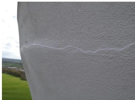
Fissure réparée (Fext_6) - voile nord-est
