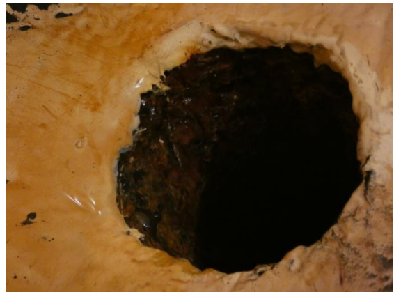
Corrosion de la canalisation de vidange
