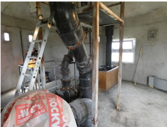
Palier sous cuve – P4
