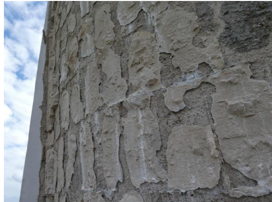
Décollement de l'isolation thermique (DECext_2) – voile nord-ouest
