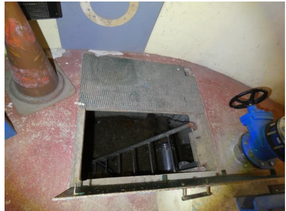
Légère corrosion trappe et échelle d'accès galerie technique
