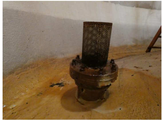
Crépine et canalisation de distribution légèrement corrodées
