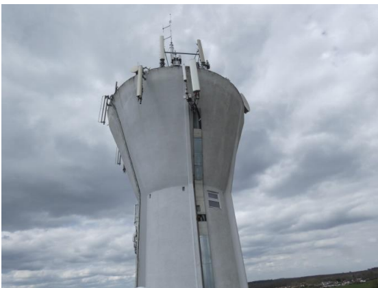
Voile cuve extérieur orienté sud-est
