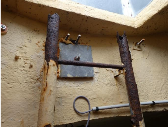
Corrosion de l'échelle d'accès à la coupole de couverture
