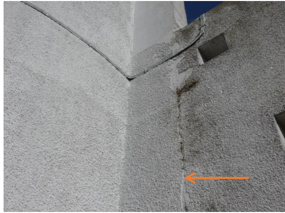
Fissure verticale au droit d'un raidisseur (Fext_21)
