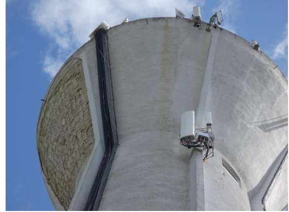
Voile cuve extérieur orienté ouest
