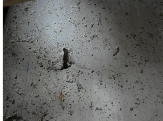
Epaufure avec armatures apparentes corrodées (EPPAint_5) – cheminée d'accès
