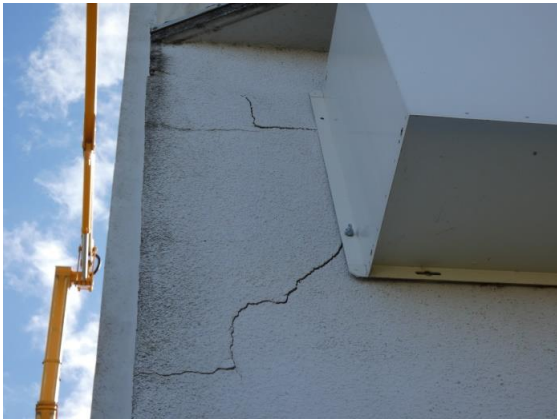
Fissures au droit de la ventilation (Fext_12)
