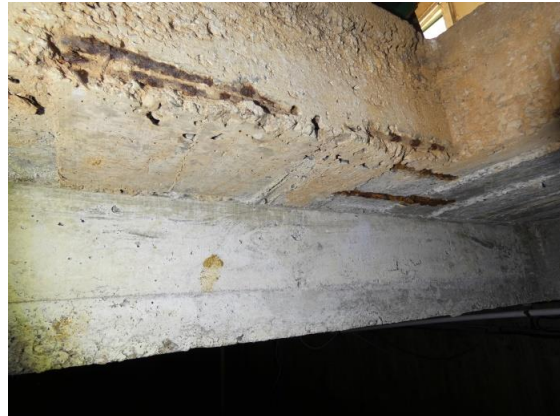
Epaufures avec armatures apparentes corrodées (EPAAint_1) – intrados P0
