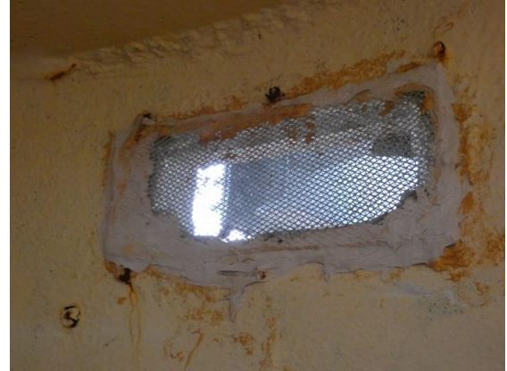
Détérioration des grilles d'aération du lanterneau
