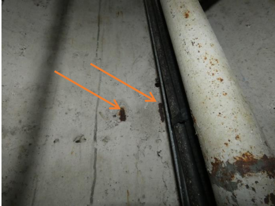
Epaufures avec armatures apparentes corrodées (EPPAint_5) – cheminée d'accès
