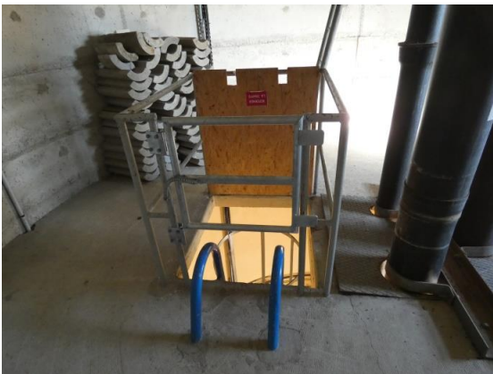
Absence de plinthes sur les garde-corps
