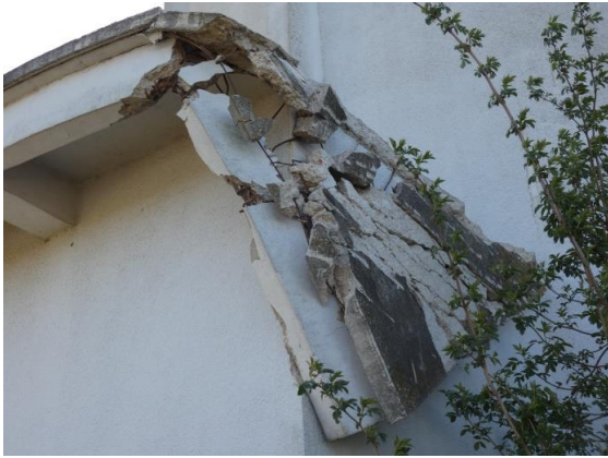
Effondrement de l'auvent (Efect_1)
