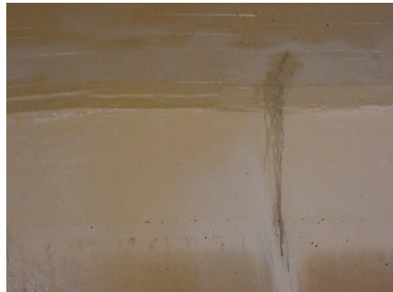
Fissuration avec épanchement de calcite (Fint_8) – intrados coupole de couverture
