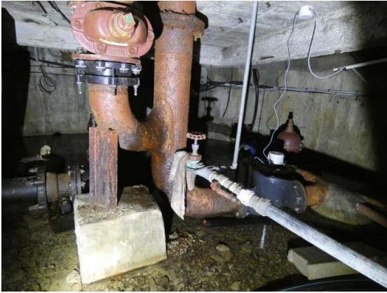
Corrosion des canalisations – galerie technique
