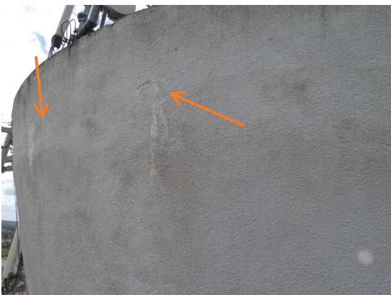
Fissuration horizontale avec épanchements de calcite (Fext_1) – voile est
