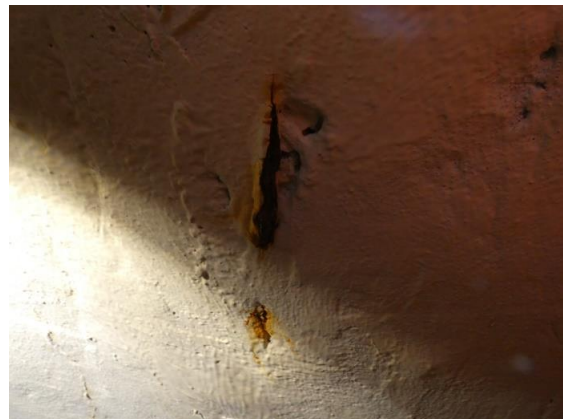
Epaufure avec armatures apparentes corrodées (EPPAint_6) – intrados coupole de couverture
