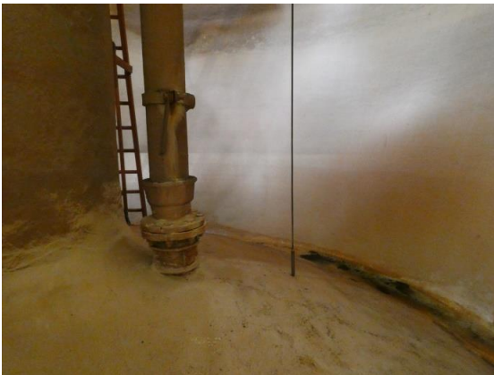
Etat de corrosion de la canalisation de trop-plein non vérifiable
