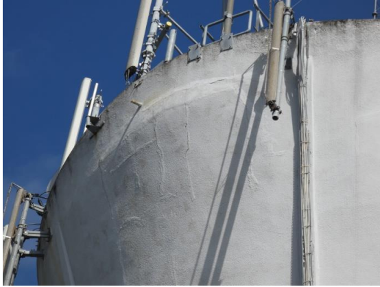
Fissure horizontale « réparée » et nombreuses fissures avec décollement de l'enduit (Fext_17) – voile sud-ouest
