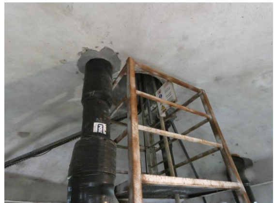
Corrosion du palier d'accès à la cheminée de la cuve
