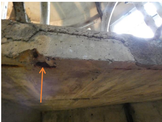
Epaufures avec armatures apparentes corrodées (EPAaint_4) – intrados P4
