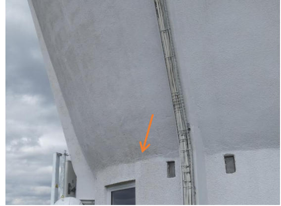
Fissure horizontale (Fext_19) – voile sud-ouest
