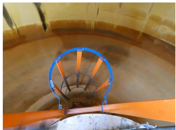
Crinoline non montante sur l'échelle d'accès cuve
