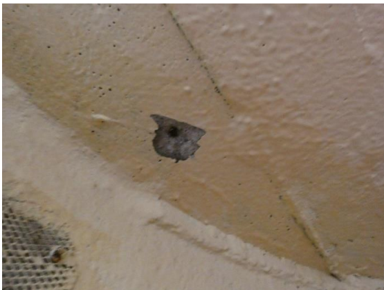
Epaufure avec armatures apparentes corrodées (EPPAint_6) – intrados dalle lanterneau
