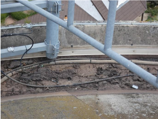
Usure du revêtement d'étanchéité de la coupole (DECext_1)
