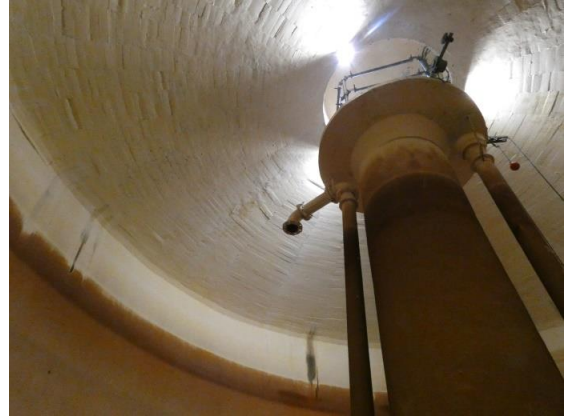
Cheminée d'accès, canalisations de distribution et trop plein
