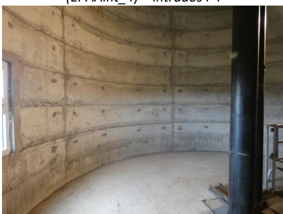
Nids de Cailloux et reprises de bétonnage – P1
