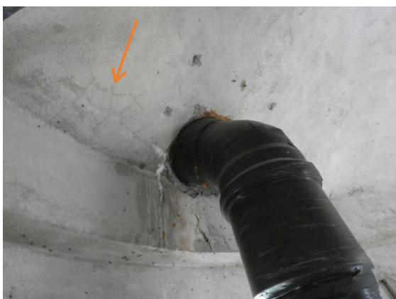
Faïençage (Fint_6) et épanchement de calcite (Fint_5) – intrados fond de cuve
