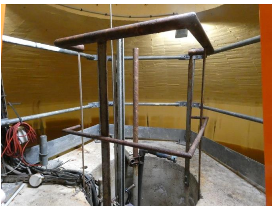
Corrosion des garde-corps du palier sommital
