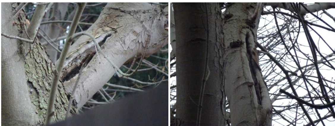
FIGURES 15 ET 16 : FISSURES SUR L'ARBRE 5 (EGIS, 2020)
