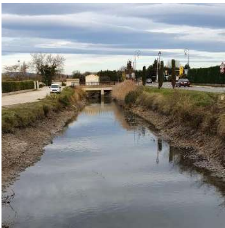
c) Revêtement en terre - état dégradé (PM-17678)
