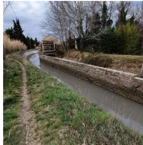
b) Enrochement – dégradé (PM-13951)
