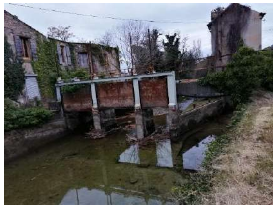
b) Vannes plates à crémaillère (OR-2247) – Dégradé
