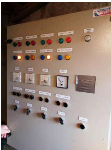
c) Face avant armoire contrôle commande
