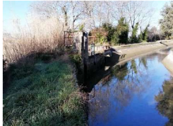
b) Décharge de Redortier (OD-10611) – Dégradé
