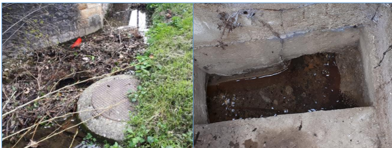
Figure 15 : Exemples d'intrusion d'ECPP
