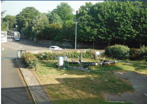
Arrivée des Eaux Brutes + de Rejet des eaux traitées avec vanne murale du bypass A2
