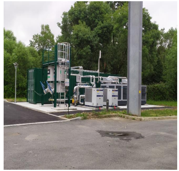
Traitement de biogaz avant injection
