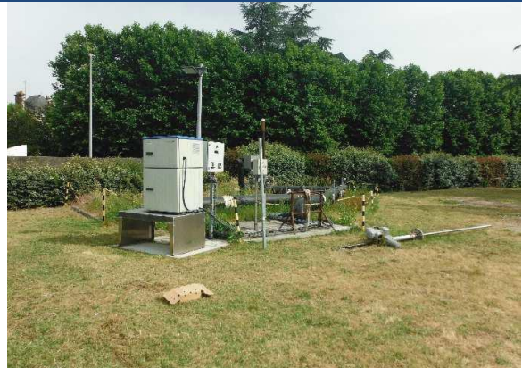
Préleveur d'auto surveillance du point A2
