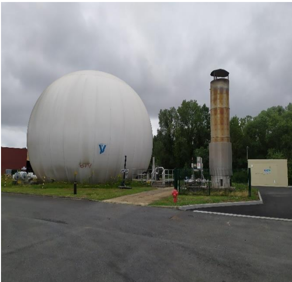
Stockage de Biogaz
