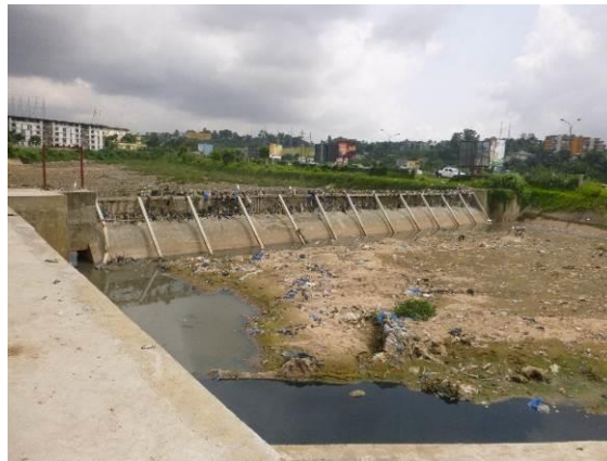
Figure 7 : Bassin de décantation équipé d'un dégrilleur à l'aval du canal du Gourou
