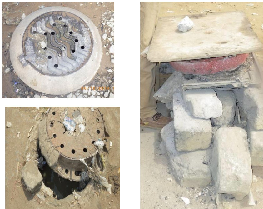
Figure 14 : Tampons et regards dégradés non étanches
