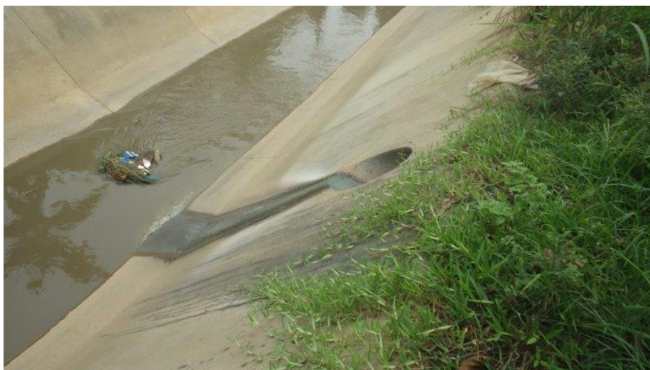
Figure 10 : Photo de l'exutoire d'un réseau d'assainissement : les eaux usées sont rejetées directement dans un canal pluvial
