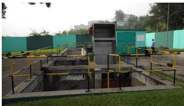
Figure 5 : Photo de la station Reoul (dégrillage/dessablage)
