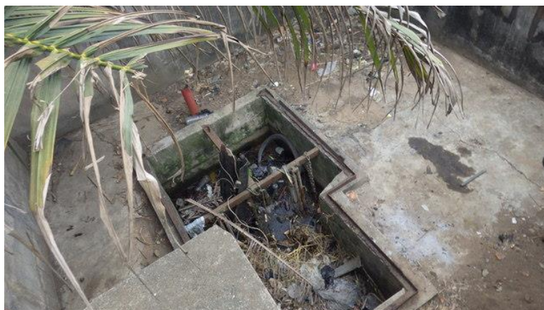
Figure 20 : Poste de refoulement hors service
