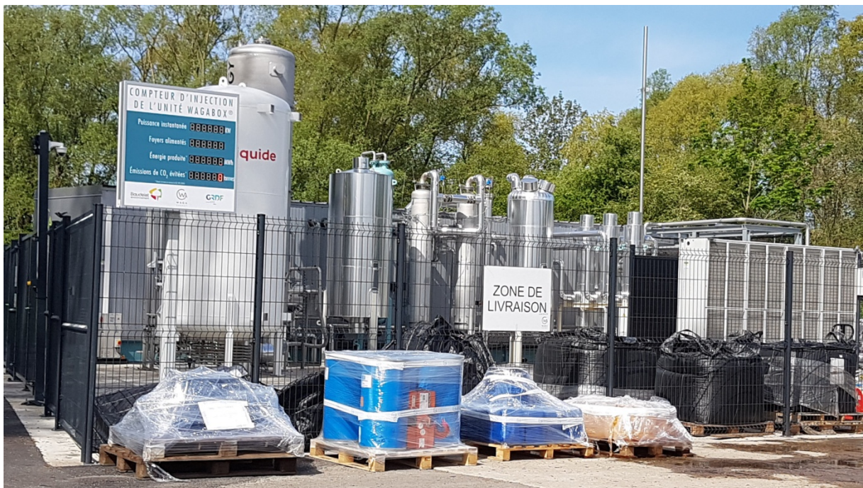
Unité Wagabox® pour la valorisation du biogaz
