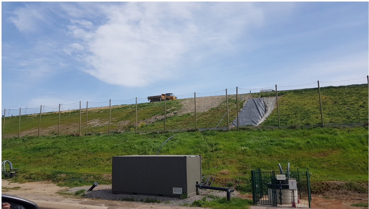
Récupération du biogaz sur l'installation de stockage des déchets non dangereux
