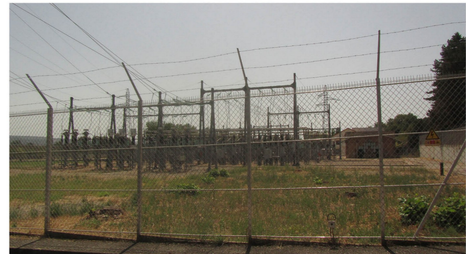
L'eau sert à produire de l'électricité. Usine hydroélectrique de la Brillanne.
