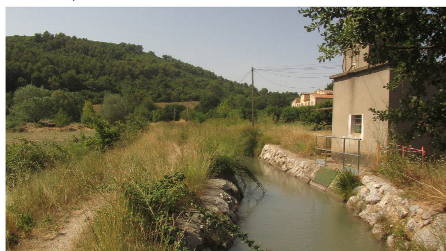
Le fonctionnement des canaux nécessite des ouvrages techniques entretenus par les aygadiers. (Canal de Manosque, 13/08/2021)
