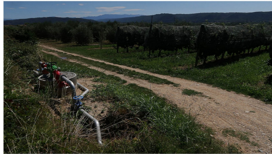
Le canal basse pression n'est visible qu'à l'endroit précis de la desserte de la parcelle. (Canal de Manosque, 05/08/2021)
