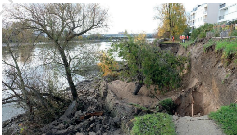
Fig. 49 : Les berges effondrées, près de Mangin. Source : Patrick Garçon, Nantes Métropole.
