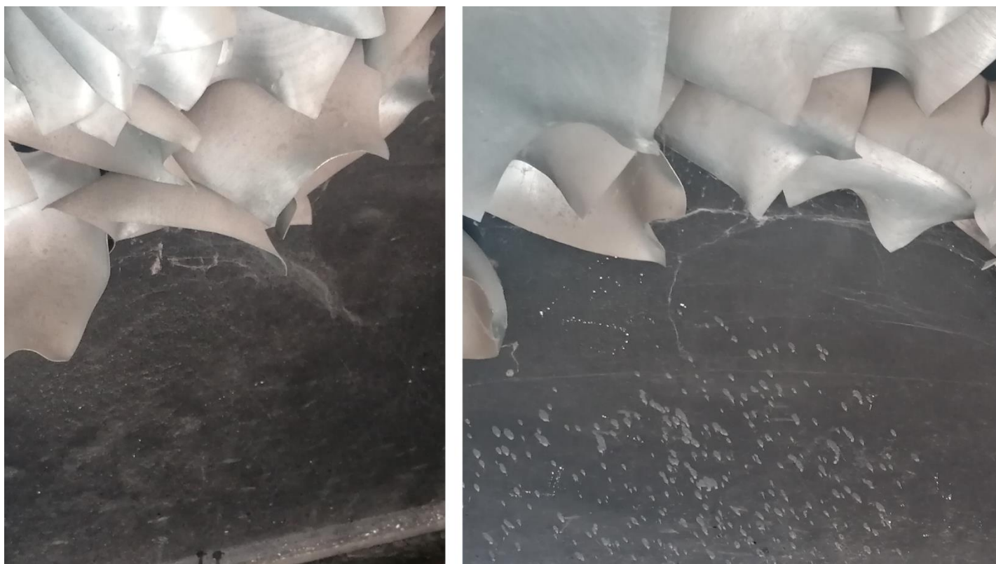
Figure n°45 : Altérations du Panneau décoratif en coque de Zinc , 1966
