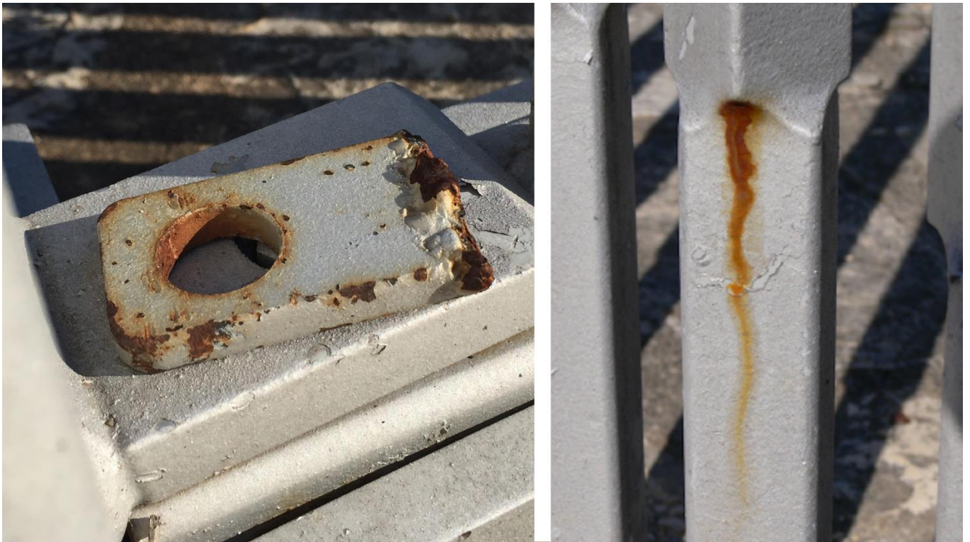
Figure n°46 : Présence de rouille sur le portail Vasarely , 1966
