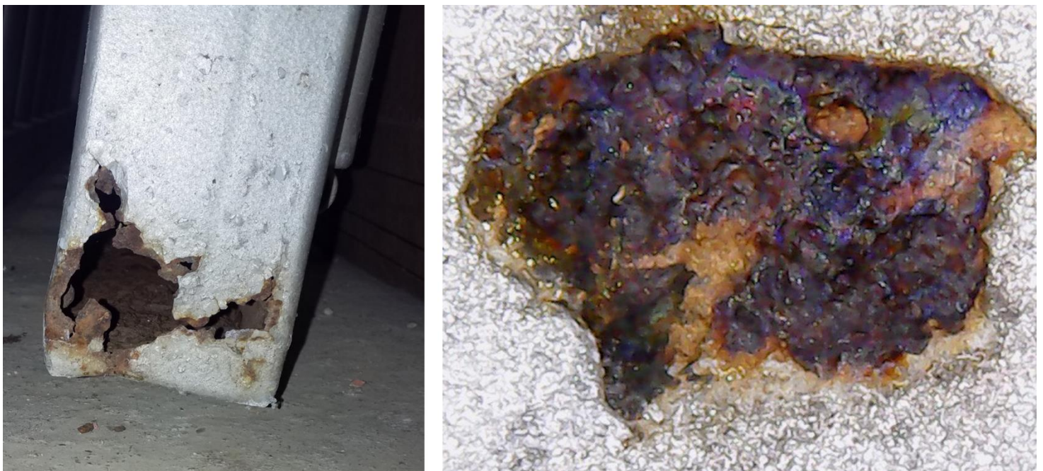
Figure n°47 : Perforation et dépôts liés à la corrosion active sur le portail Vasarely , 1966
