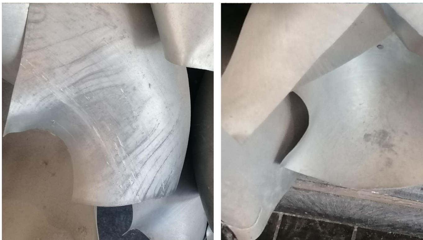
Figure n°44 : Altérations du Panneau décoratif en coque de Zinc , 1966
