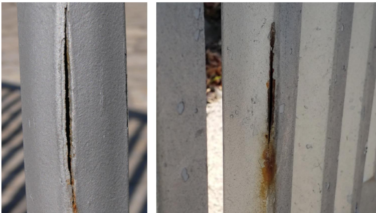
Figure n°48 : Apparition de fissures sur le Portail Vasarely , 1966
