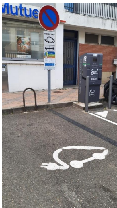
Photographie 15 - Borne de recharge pour voitures électriques à Saint-Sulpice-la-Pointe
