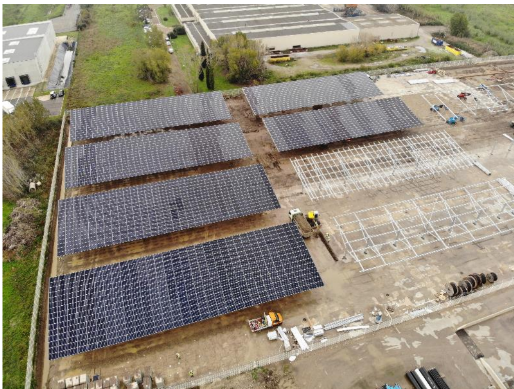
Figure 15 : exemple d'ombrière photovoltaïque (Fleury-Mérogis projet Valeco)
