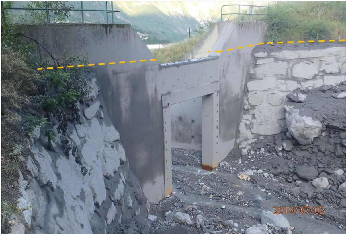
Figure 35 : Laisses de crue apparentes sur le barrage filtrant et sur les digues latérales en enrochements (photo RTM73, 02/07/2019).
