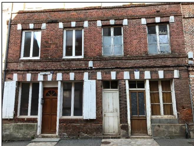
Figure 51 : Maisons mitoyennes dégradées dans le bourg de Livarot le 10/03/2022
