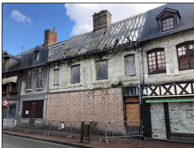
Figure 55 : Ancienne maison du bourg d'Orbec fortement dégradée le 09/04/2022
