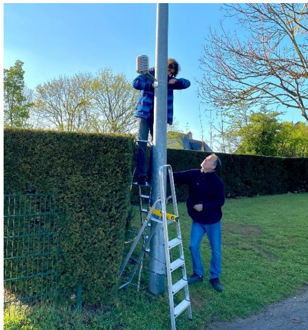
Figure 16 : Installation d'une station météorologique METEOHELIX (située au château de Caen). Photographie : Matthieu David.
