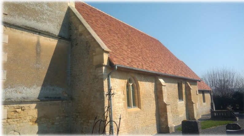
Figure 87 : Église de Berville restaurée, photographie prise par Edeline Antoine le 24/03/2022
