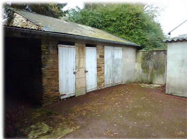
Photo 40 : Photographie des bâtiments entourant la mairie déléguée de Saint-Martin-de-Sallen (Auteur : EDELINE Antoine, le 17/02/2022)
