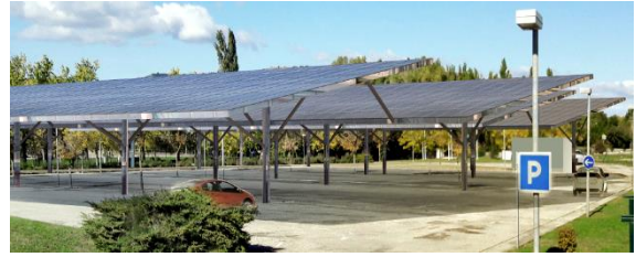
Figure 47 : Ombrière FORUM de 500 kWc dans le Gard (30).
